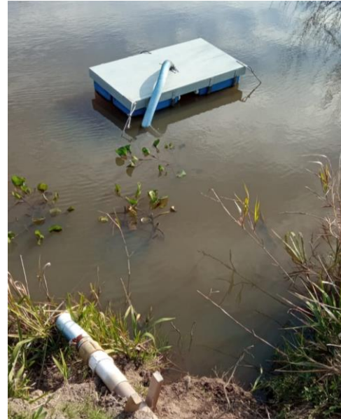
Captação água bruta – Arroio Padre Doutor
