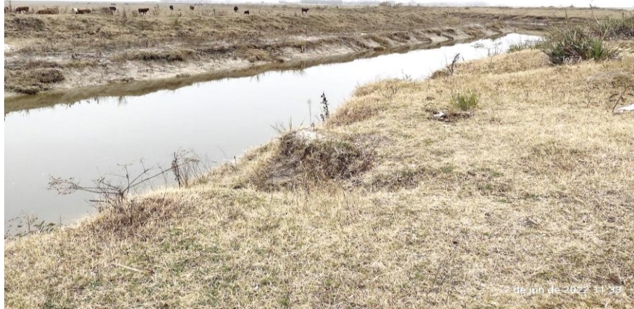
Figura 19 – Vistoria do canal de irrigação, vista para montante, que capta água da Lagoa Mirim para irrigação de arroz.
